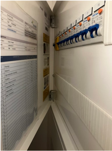
Bilde av sikringskap
