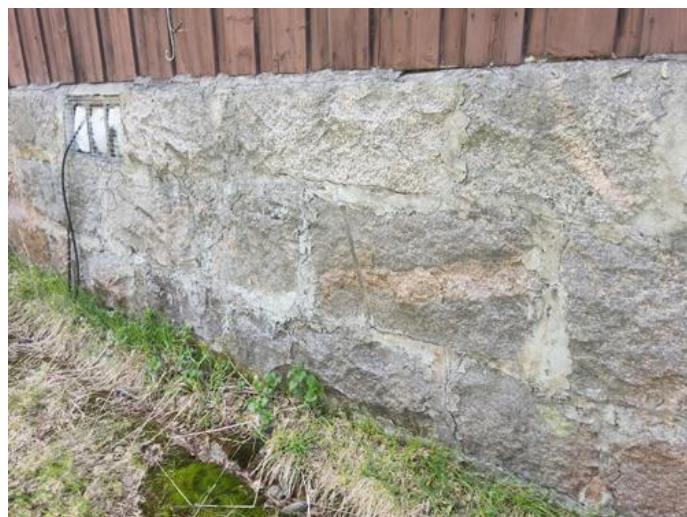
Grunnmur, fundamenter - [Eksempel på sprekker i grummur på enebolig. ]
