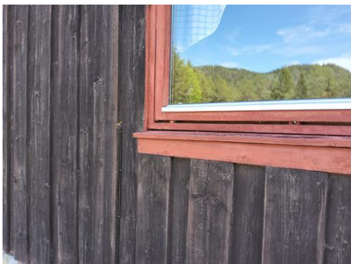
Dører og vinduer - [Eksempel på manglende beslag i overgang vinduer og vannbrett. ]
