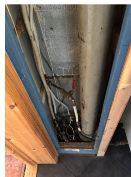
Viser kobber-rør i åpen kasse på kjøkken i 1 etg.
