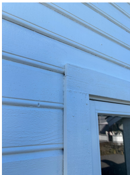
Viser manglende vannbrett og beslag.
