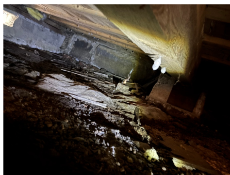
Viser fuktig krypkjeller.
