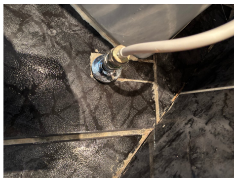
Viser utett rørgjennomføring.
