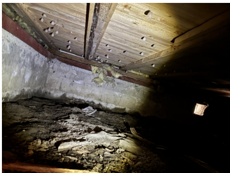
Viser fuktig krypkjeller.
