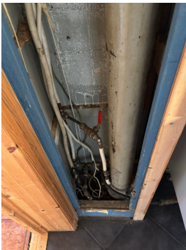
Viser soilrør i åpen kasse på kjøkken i 1 etg.
