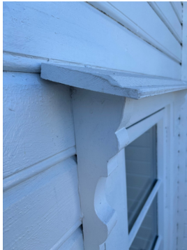
Viser manglende beslag over vannbrett og inn i veggen.
