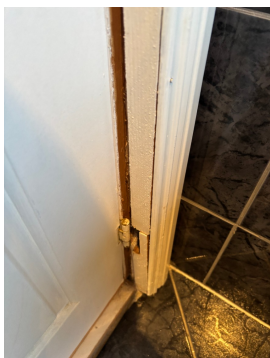
Viser løs foring og lister på baderomsdør i 1 etg.
