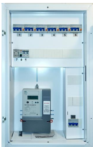
Forenklet vurdering av det elektriske anlegget - [Sikringsskap]
