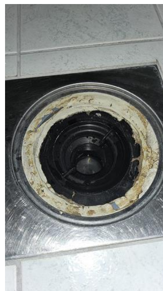
Avløpsrør (ink. sluk) - [Sluk 2 bad]
