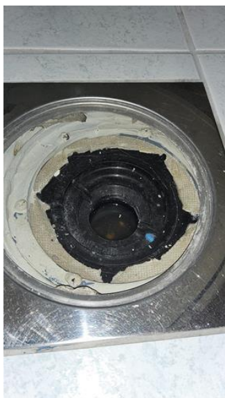
Avløpsrør (ink. sluk) - [Sluk 1 bad]
