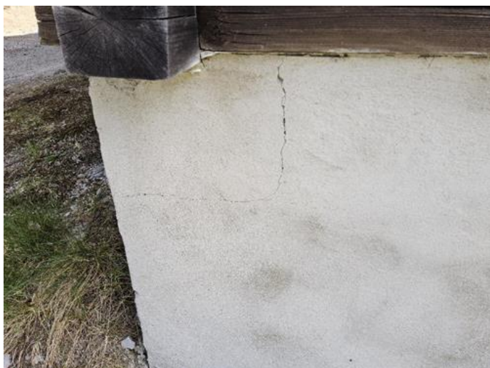
Grunnmur, fundamenter - [Riss/sprekker i grunnmur]
