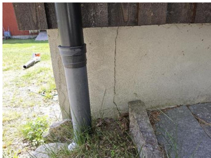
Grunnmur, fundamenter - [Riss/sprekker i grunnmur]
