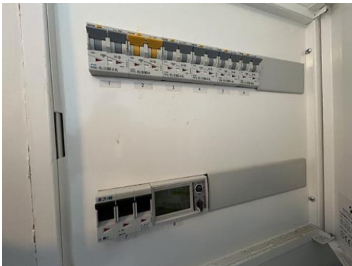
Elektrisk anlegg - [Fordeling utleiedel]
