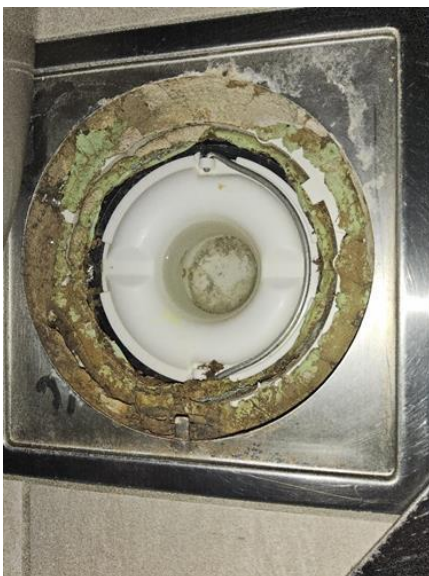
Våtrom - [Sluk bad 2.etg ]
