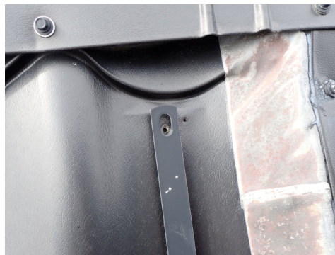
Hull etter skruer i takplate (ved møne)
