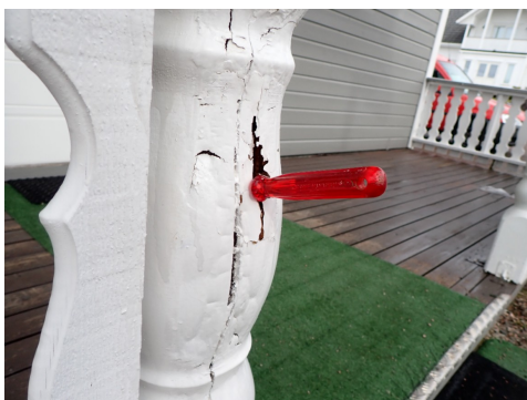
Råte i rekkverks-stolpe
