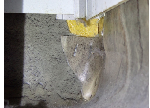
Eksempel på ufagmessig utførelse i hjørne
