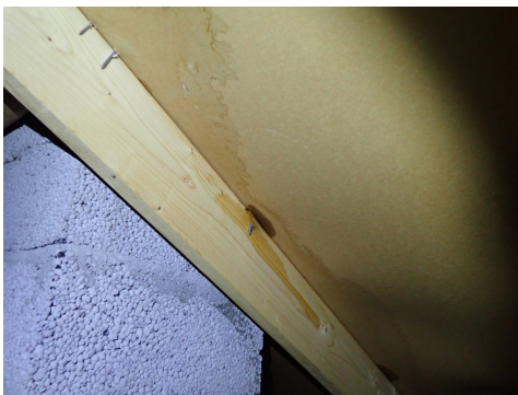
Synlig fukt, har fulgt spiker
