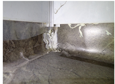
Eksempel på ufagmessig utførelse i hjørne
