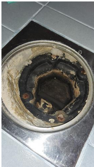
Våtrom - [Sluk bad loftsetasje]
