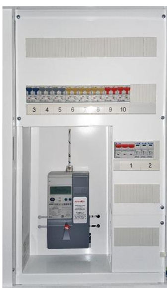
Forenklet vurdering av det elektriske anlegget - [Sikringsskap]
