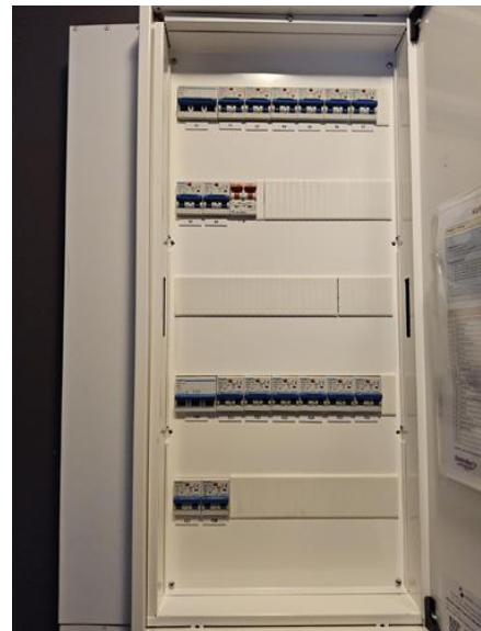
Elektrisk anlegg - [Sikringskap]
