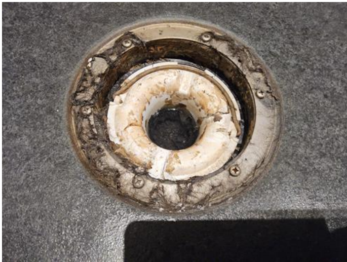
Avløpsrør (ink. sluk) - [Sluk baderom]
