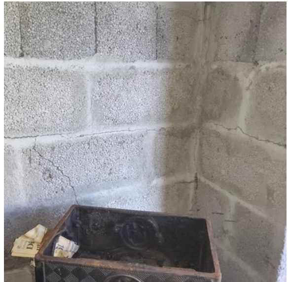
Utvendig - [Eksempel på sprekker i grunnmur]
