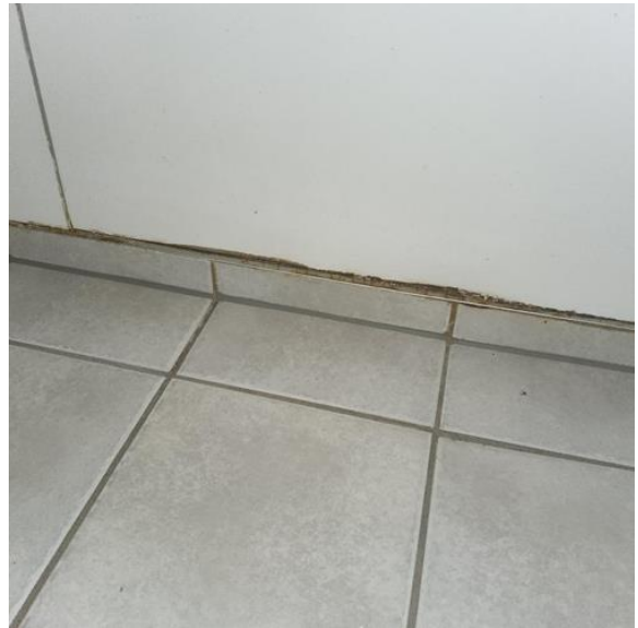
Våtrom - [Eksempel på fuktskader bad underetasje ]
