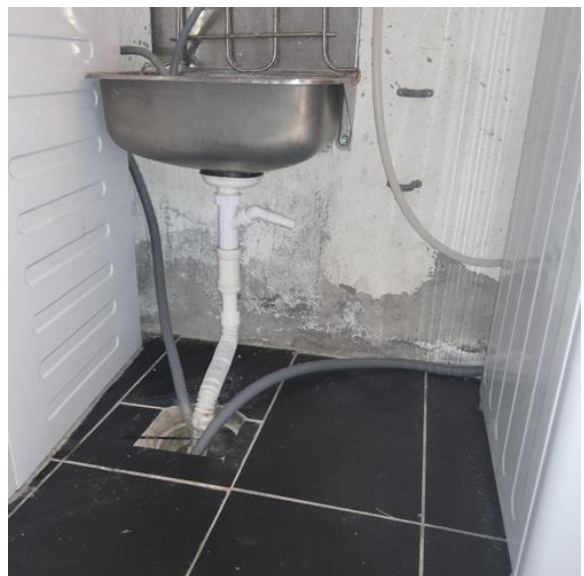
Innvendig - [Eksempel på slitasjer vaskerom]
