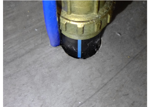
Åpning mellom belegg og rør, vanninntak
