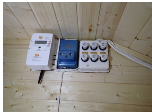
Inntak og sikringsboks på soverom mot sørøst
