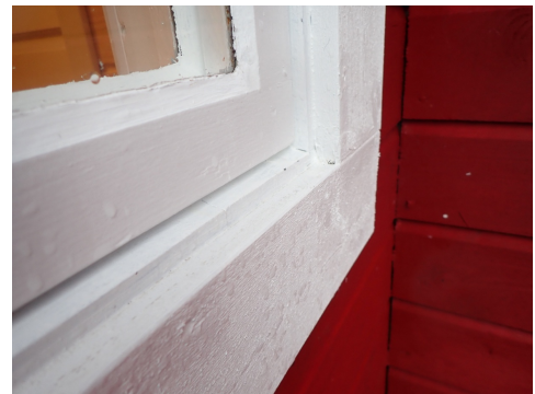
Feil utførelse i nedkant
