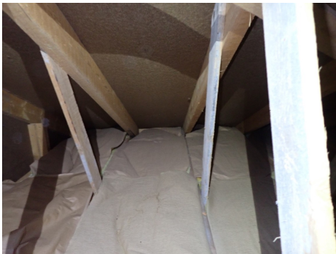
Manglende lufting ved raft
