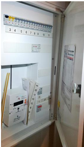
Elektrisk anlegg - [Sikringskap]
