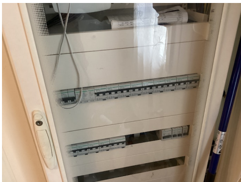
Bilde av sikringskap, skapet er plassert på bod.
