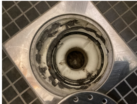
Bilde av sluk utpå gulvet
