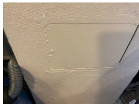
Feieluke er overmalt og åpning av denne krever verktøy.
