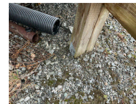
Terreng rundt søyle tærer på treverket.
