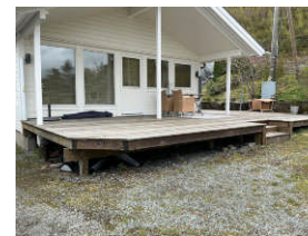
Terrasse fremstår med slitte overflater og behov for vedlikehold.
