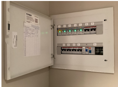
Bilde av sikringskap.
