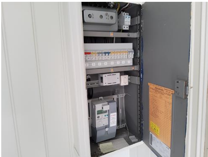
Elektrisk anlegg - [Sikringsskap. ]
