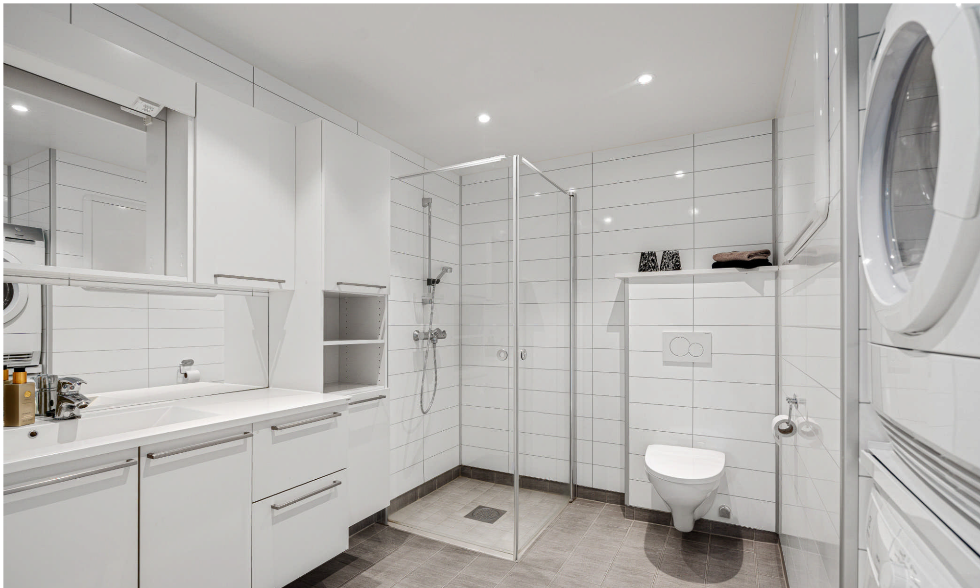
Bad med opplegg for både vaskemaskin og tørketrommel
