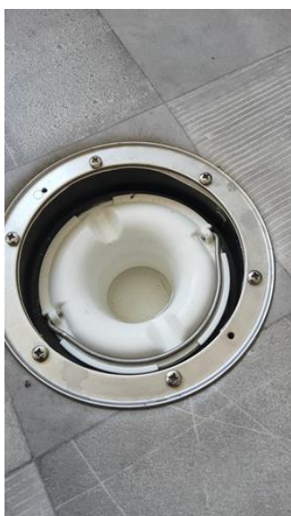
Avløpsrør (ink. sluk) - [Sluk vaskerom]
