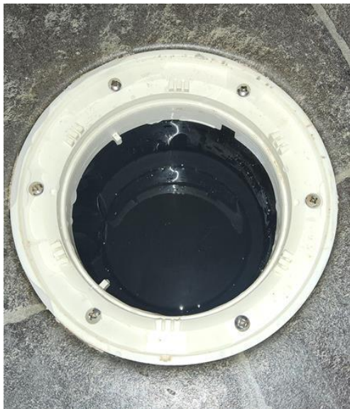
Avløpsrør (ink. sluk) - [Sluk bad]
