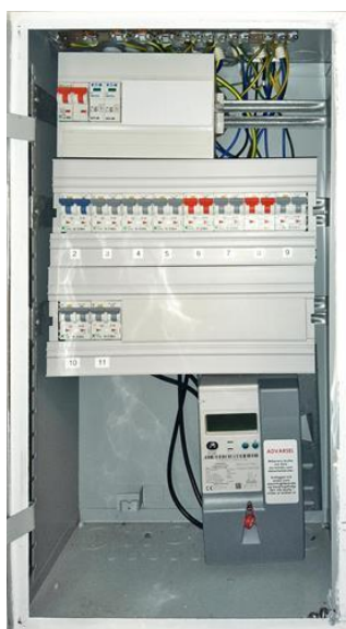
Forenklet vurdering av det elektriske anlegget - [Sikringsskap]
