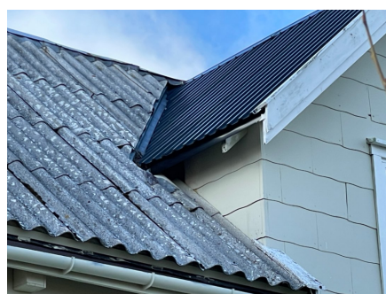
Mulig lekkasjested på gradrenne ark
