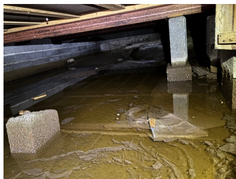
Viser stående vann i krypkjeller.
