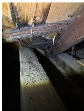
Viser en av flere fuktskjolder i undertaket
