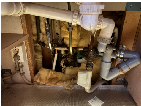
Viser røropplegg i kjøkkenbenken
