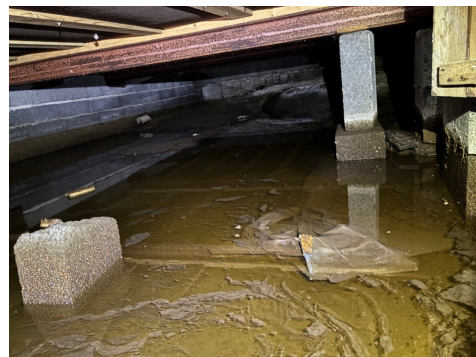
Viser stående vann i krypkjeller.
