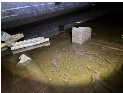
Viser stående vann i krypkjeller
