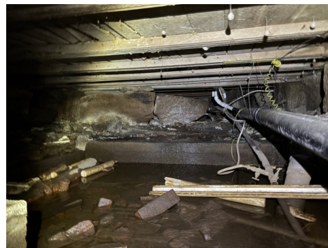
Viser stående vann i krypkjeller
