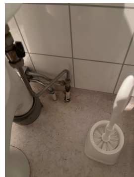
Viser utette rørgjennomføringer i gulvet
