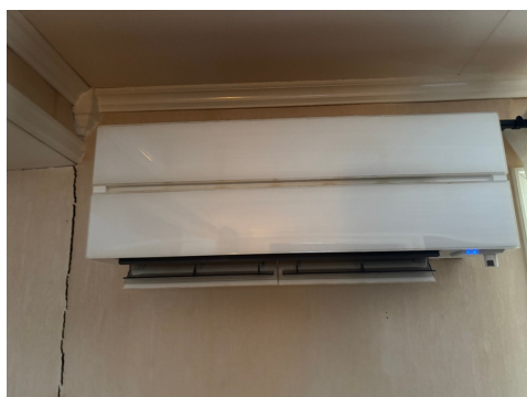
Viser varmepumpe i 1 etg
