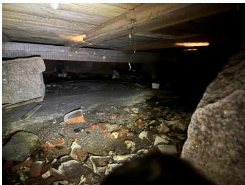
Viser krypkjeller uten tilgang
