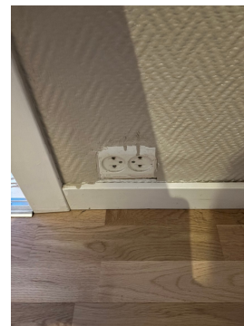
Viser innbygget kontakt i 2 etg.
