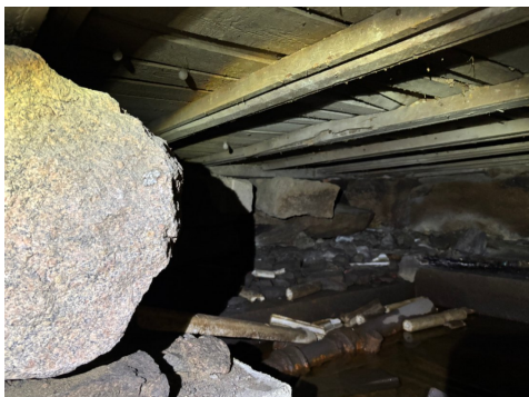
Viser gammelt bjelkelag med kokonger og spor etter borebiller.
