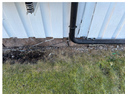
Viser manglende fuger mellom granittmur.
