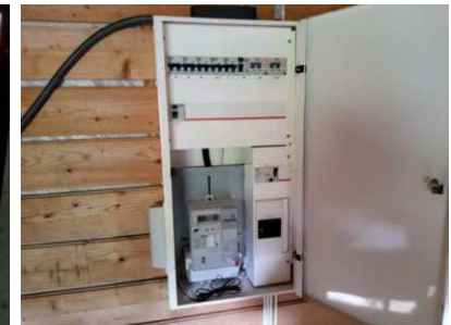
Elektrisk anlegg - [Sikringskap]
