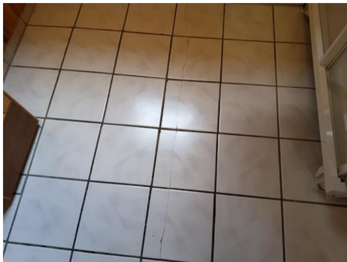
Overflater gulv - [Riss/sprekker i gulvoverflate bad hoveddel.]
