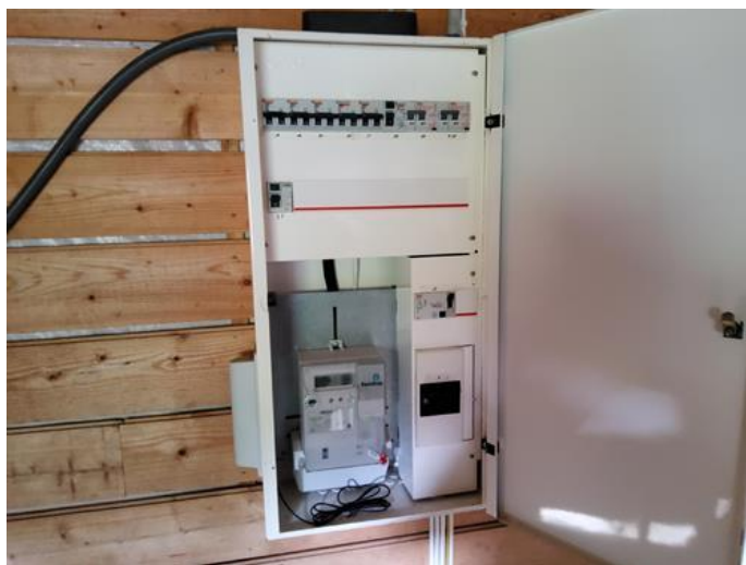
Elektrisk anlegg - [Sikringskap]
