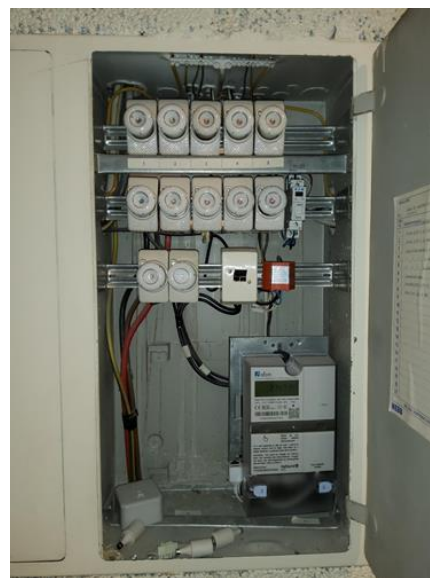
Elektrisk anlegg - [Sikringsskap ]
