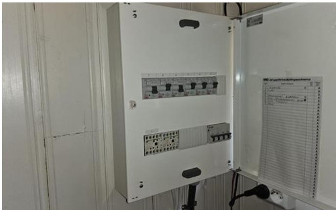
Elektrisk anlegg - [Sikringsskap. ]
