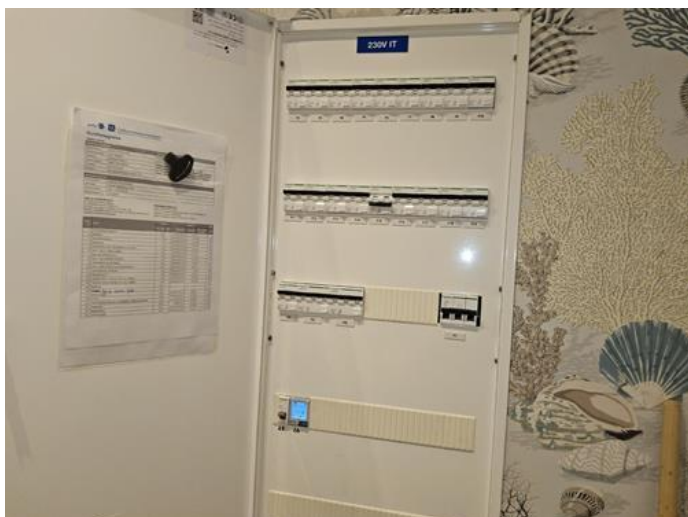
Elektrisk anlegg - [Sikringsskap]
