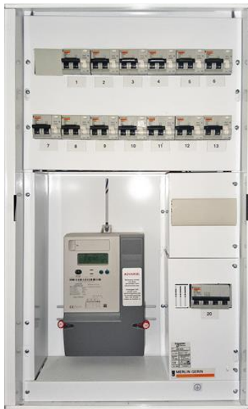
Forenklet vurdering av det elektriske anlegget - [Sikringskap]
