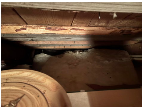
Viser dårlig ventilasjon av loft
