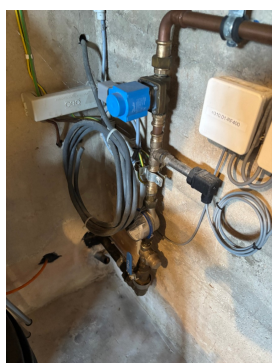
Viser inntak av vann + stoppekran.
