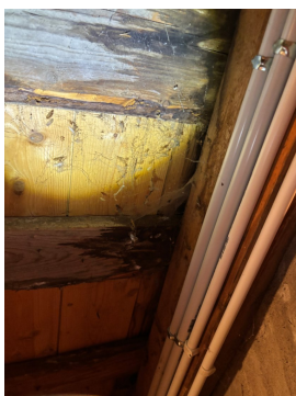
Viser fuktskjolder i undertaket.
