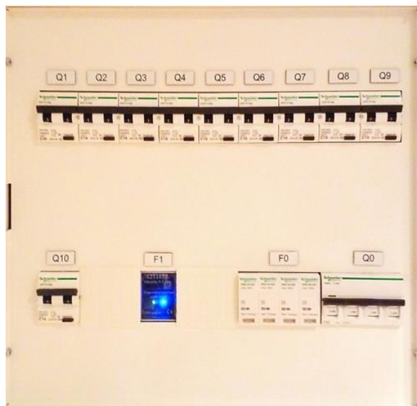
Forenklet vurdering av det elektriske anlegget - [Sikringsskap]
