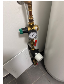
Viser inntak, stoppekran og vannmåler.
