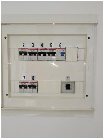
Elektrisk anlegg - [Sikringsskap]
