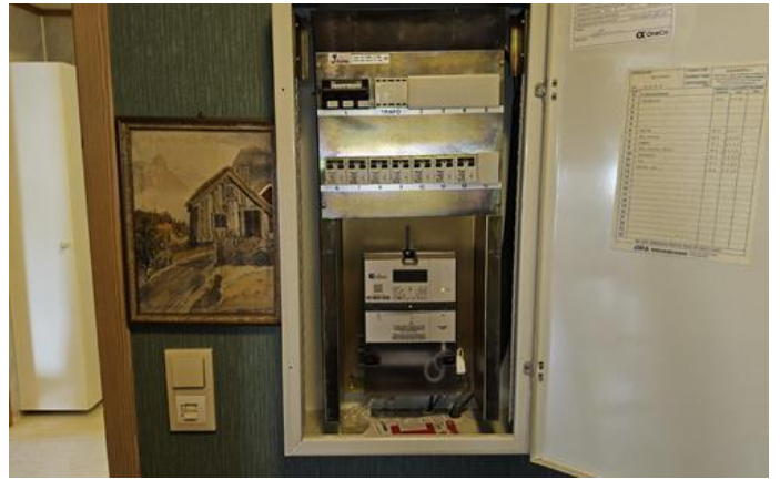
Elektrisk anlegg - [Sikringskap. ]
