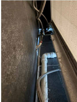
Viser vann/avløpsrør/slanger som ligger rett på gulvet
