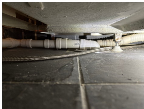
Viser løse vann og avløpsrør/slanger.
