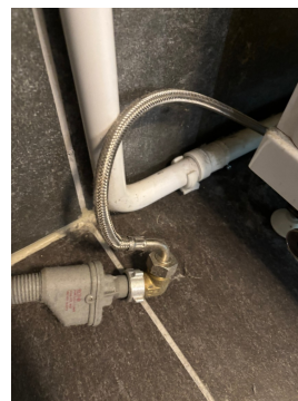
Viser løse vann/avløps slanger/rør.
