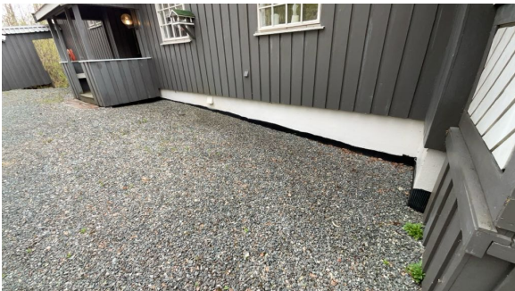
Synlig grunnmursplast, mangler kantlist
