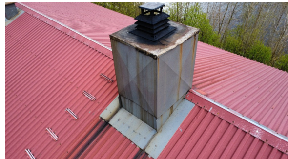
Bilde tatt med drone av pipehatt, synlig overflate rust
