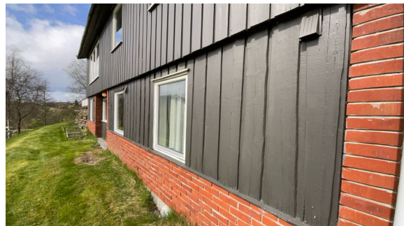
Sprekker i kledning
