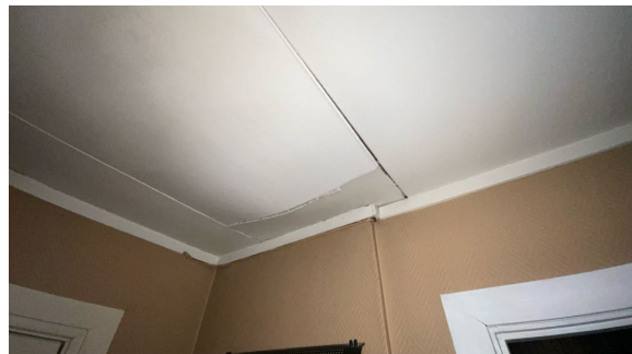
Skade på himlingsplater i gang ved vindfang
