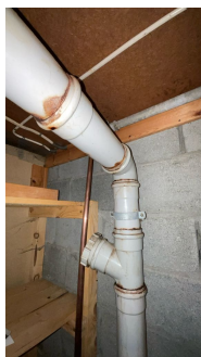
Misfarging rundt skjøter på avløpsrør fra kjøkken
