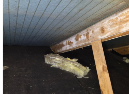
Ingen synlig ventilering på raftekasser. Synlig hvitt mugg på enkelte sperrer som følge av lekkasje/kondens fra undertak. Ingen forhøyde fuktavvik er målt på befaringsdagen
