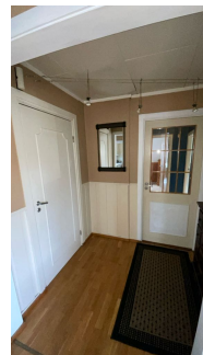
Dør til vindfang og gang ved soverom sett fra gang ved stue. Dør til vindfang tar i karm.
