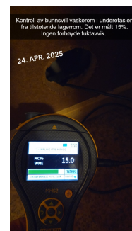
Kontroll av bunnsvill vaskerom i underetasjen fra tilstøtende lagerrom. Det er målt 15%. Ingen forhøyde fuktavvik.
