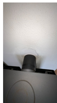
Sprekk i pipe ved røykrør i kjeller
