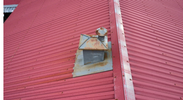
Bilde tatt med drone av luftehatten, synlig overflate rust
