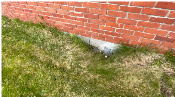
Synlig utvendig ventil på kryprom for oppforet kjellergulv.
