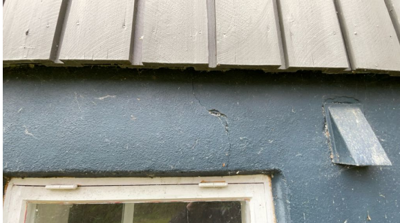
Sprekk i puss over vindu
