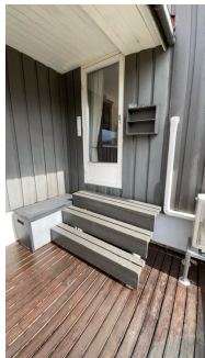
Trapp fra stue til veranda mangler rekkverk
