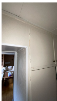
Mangler deler av tapet på garderobeskap kontor
