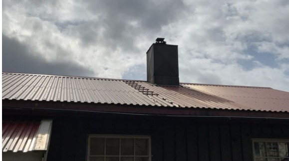
Heng i takrenne og det mangler stigetrinn
