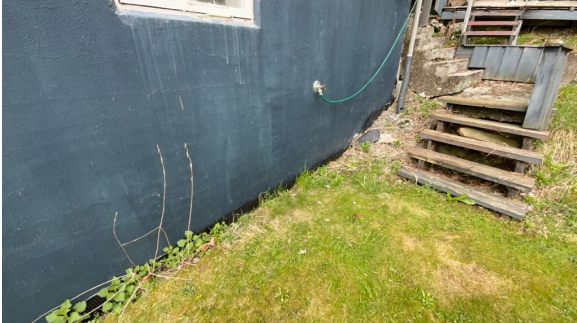
Synlig grunnmursplast, mangler kantlist
