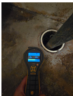
Fuktsøk på gulv ved sluk. Det er målt noe forhøyde fukt
