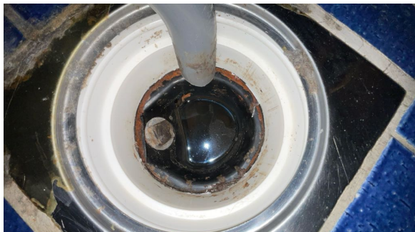
Synlig rust i sluk
