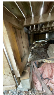
Vegg under veranda på inngang to er presset inn og fundamentering er svak
