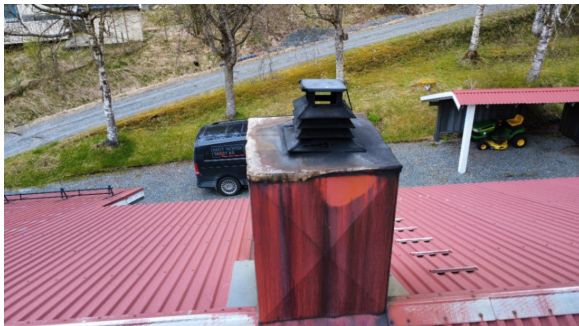
Bilde tatt med drone av pipehatt, synlig overflate rust
