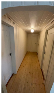
Dør til lagerrom, bad og 2 soverom i underetasjen. Dør til bad tar i karm
