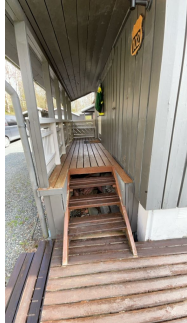
Trapp fra veranda opp til inngang 2 mangler håndløper på 2 sider
