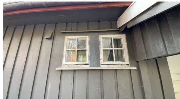
Koblede vinduer på bad 1. etasje fra byggeår
