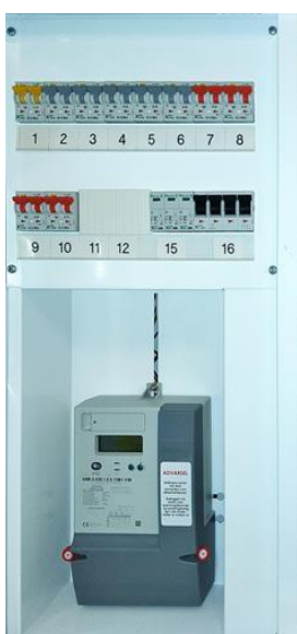
Forenklet vurdering av det elektriske anlegget - [Sikringskap]
