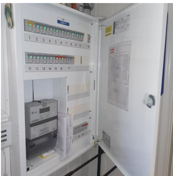
Elektrisk anlegg - [Sikringsskap og kursoversikt ]
