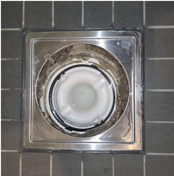
Avløpsrør (ink. sluk) - [Sluk dusjsonen bad 2.etasje ]
