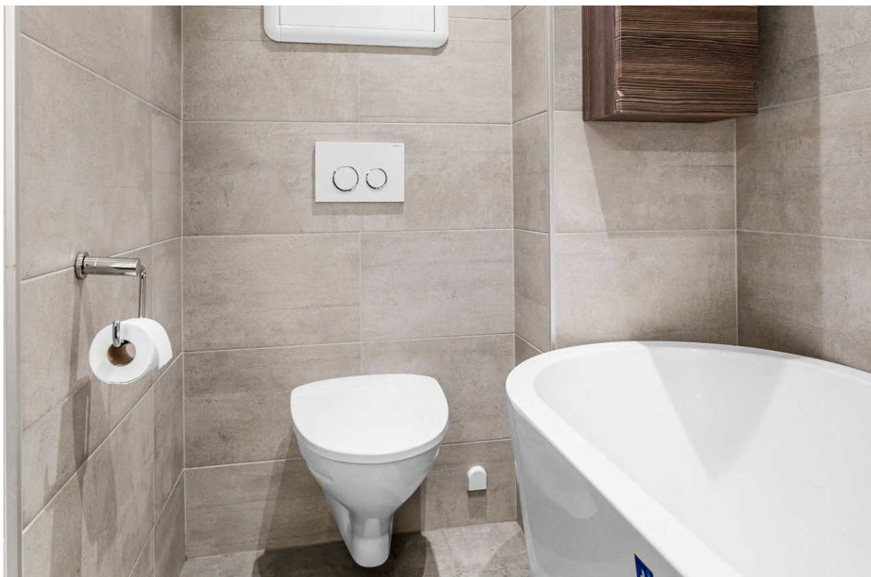
Vannskap for rør-i-rør system over toalett.
