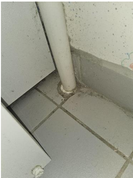
Våtrom - [Utette avløpsgjennomføringer i gulv vaskerom ]
