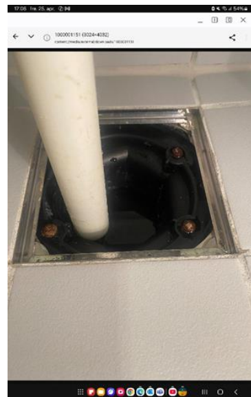
Våtrom - [Sluk vaskerom ]
