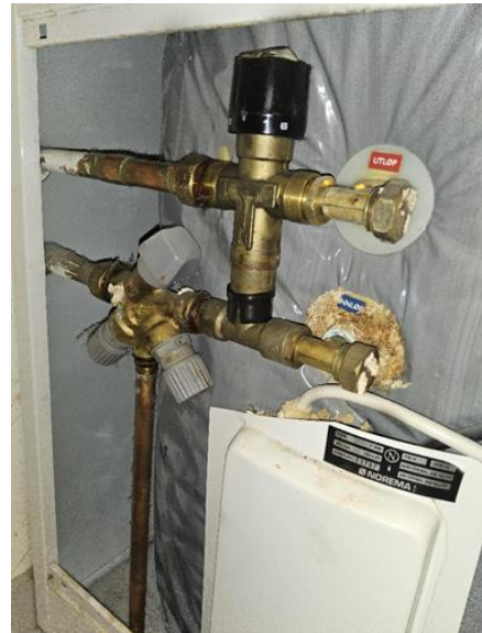
Våtrom - [Korrosjon på koblinger til varmtvannsbereder vaskerom ]
