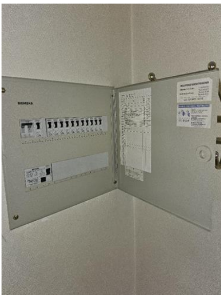
Elektrisk anlegg - [Sikringsskap med jordfeilbryter plassert i gang.]
