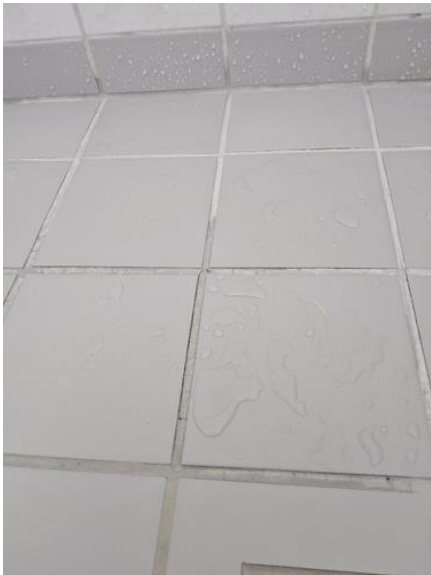
Våtrom - [Sprekker i flisfuger dusjsone]
