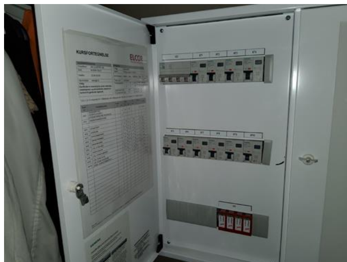
Elektrisk anlegg - [Sikringsskap ]
