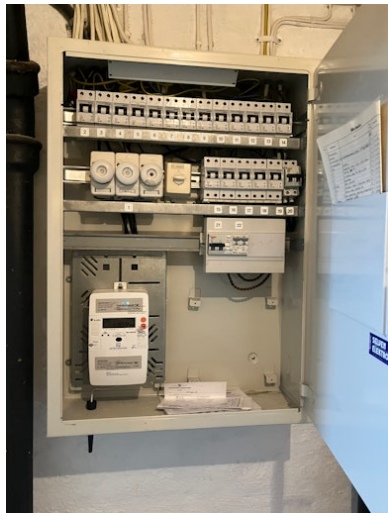
Bilde av sikringska
