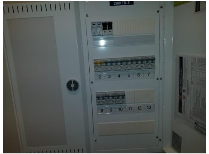
Elektrisk anlegg - [Sikringskap.]
