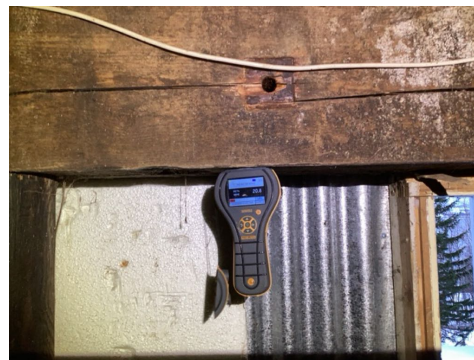
Dragere under hytten. høy fuktighet + skeivheter
