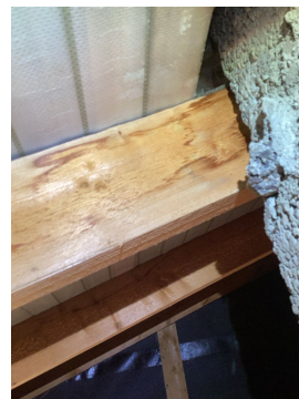
Vannmerker rundt pipe og på konstruksjonen.
