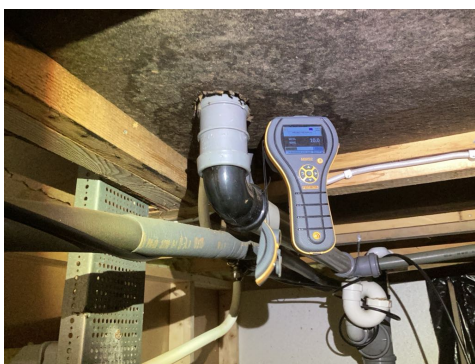
Fuktmereker i avløp fra kjøkken.
