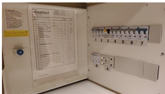
Elektrisk anlegg - [Strømskap]
