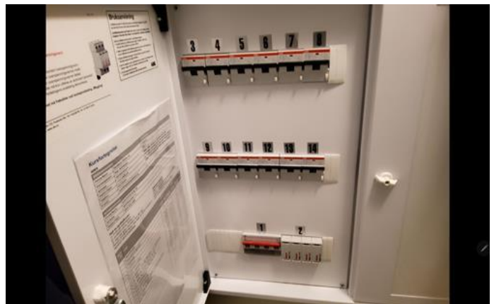
Elektrisk anlegg - [Sikringsskap ]
