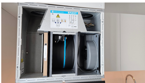
Kontroll av ventilasjonsaggregat.
