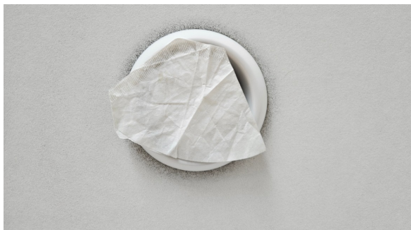
Funksjonstest av avtrekk.
