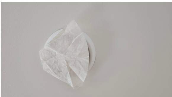
Funksjonstest av avtrekk.
