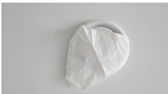
Funksjonstest av avtrekk.
