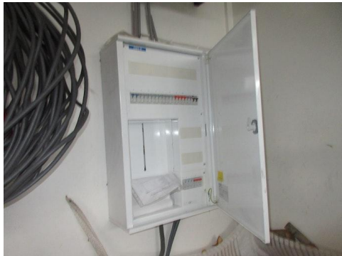
Sikringskap i sokkeletasjen
