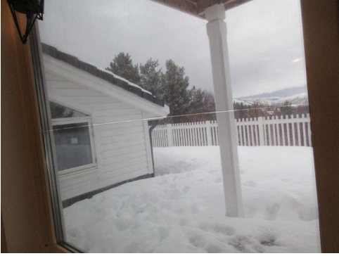
Horisontal sprikk i vindusglass.
