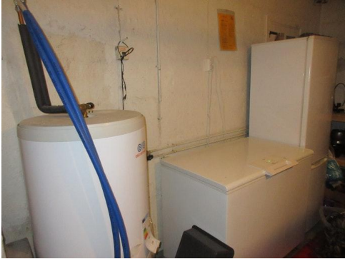
Røranlegg ved VVB
