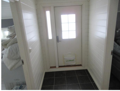
Kattehull i dør i sokkeletasjen.
