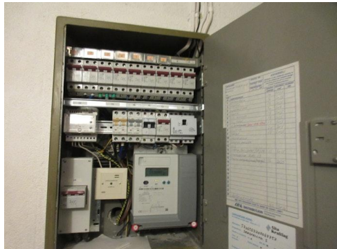
Sikringskap i bod i sokkeletasjen
