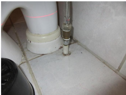
Riss i flis ved rørgjennomføring.
