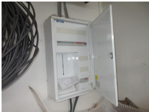
Sikringskap i sokkeletasjen
