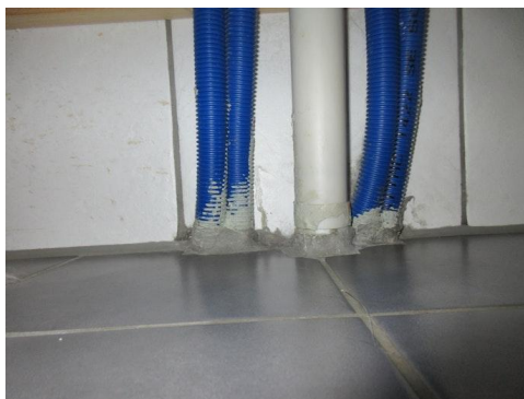
Rørgjennomføringer i gulv.
