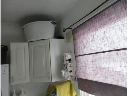
Vaskerom med naturlig avtrekk.
