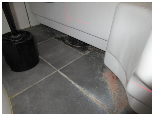
Sluk under dusjkabinett
