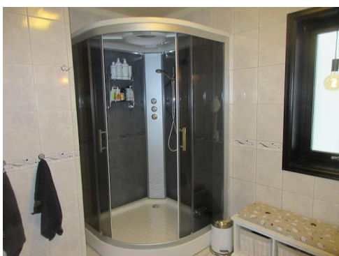
Steamdusj på bad hovedetasjen
