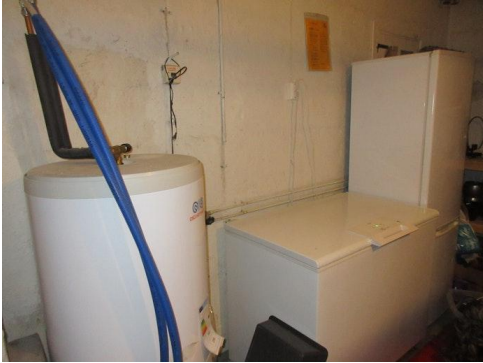
Rørlegg ved VVB
