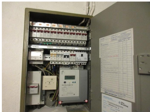
Sikringskap i bod i sokkeletasjen
