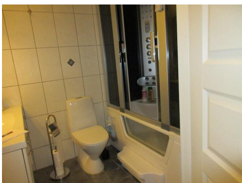
Stemdusj og WC på bad i sokkeletasjen
