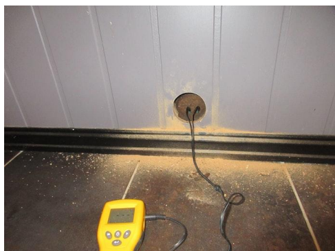
Fuktsøk mot våtsone på bad.
