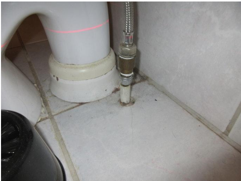
Riss i flis ved rørgjennomføring.
