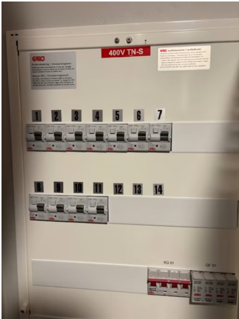
Sikringsskap med automatsikringer plassert i bod/teknisk rom.
