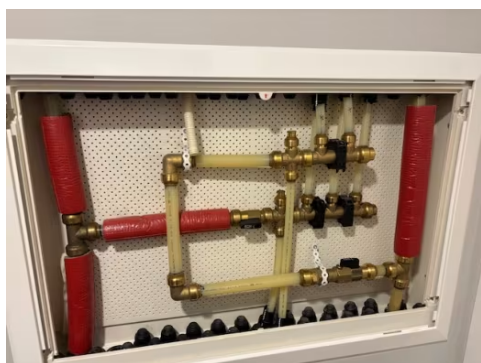
Rørfordelerskap plassert i bod.
