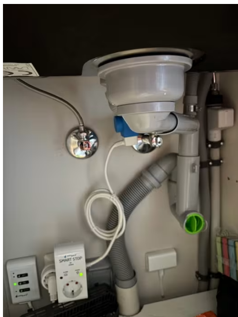
Avløpsrør i underskap vask på kjøkkenet.
