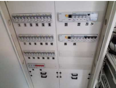
Elektrisk anlegg - [Sikringskapp. ]
